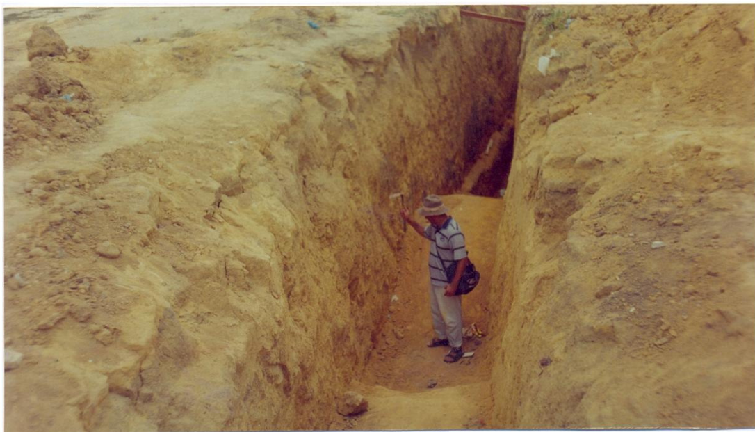
Foto 08 – Bairro U.D.R. Esta vala em alguns patamares a profundidade atinge 5m. Autor: Márcio Felix, 2000.
