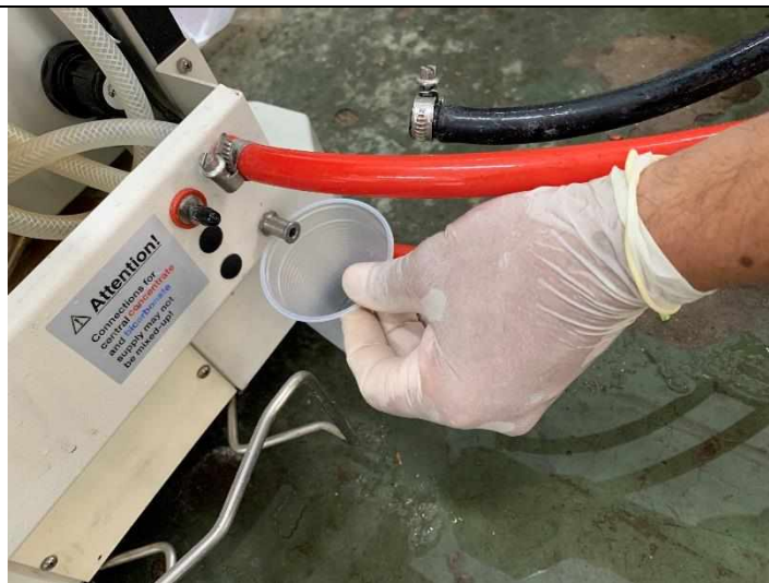
Figura 63 - Mangueira do rejeito (preta) solta
