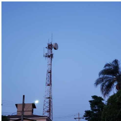
Figura 3.5 – Torre da empresa TIM Celular.
