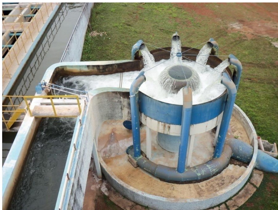
Figura 4 - Chegada da Água Bruta.
