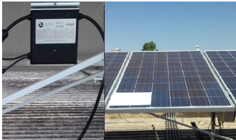
Figura 49: Sombreamento parcial realizado no módulo FV, o qual está conectado ao Microinversor
