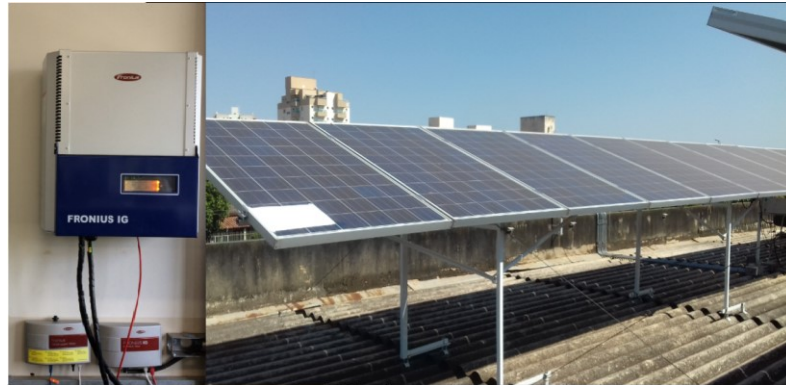
Figura 48: Sombreamento parcial realizado na string que alimenta o inversor Fronius.
