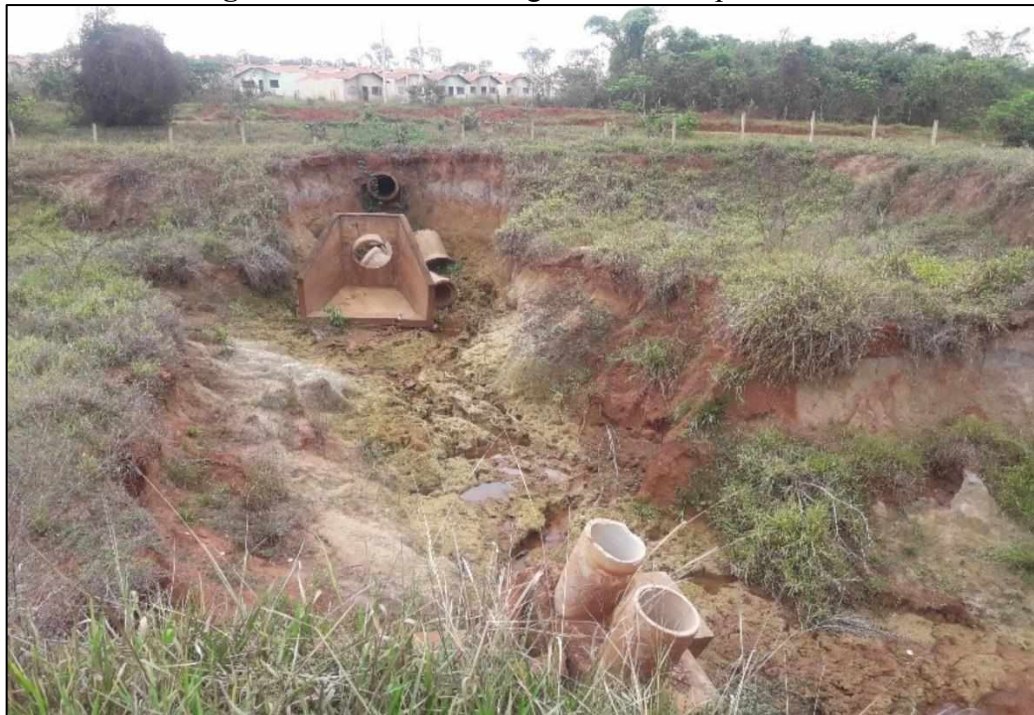
Figura 28: Rede de drenagem destruída por erosão
