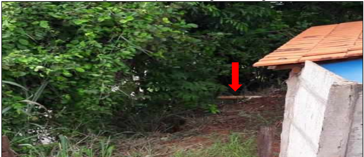
Figura 15: Lançamento de esgoto no córrego
