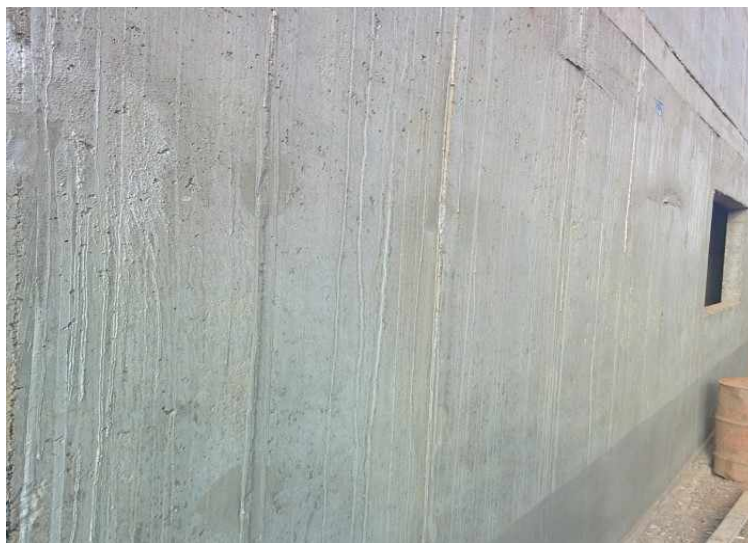
Figura 26: Superfície irregular da parede
