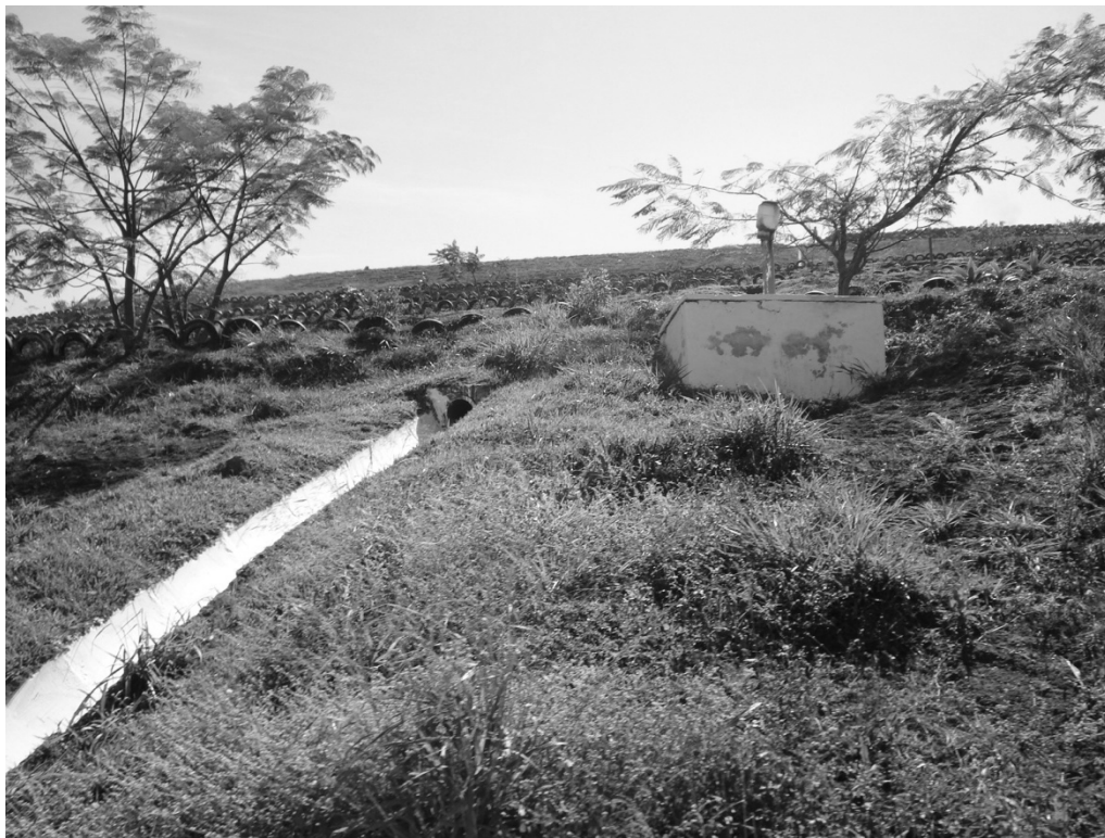
Figura 45: Canaleta de drenagem de águas pluviais no aterro sanitário de Uberlândia. Fonte: A autora, 2009.
