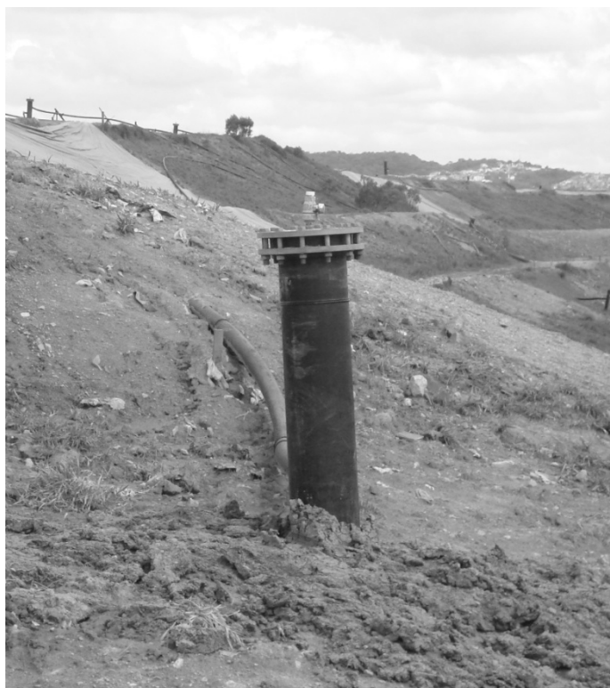
Figura 35: Dreno para sucção de biogás, aterro Bandeirantes, São Paulo - SP. Fonte: A autora, 2009.
