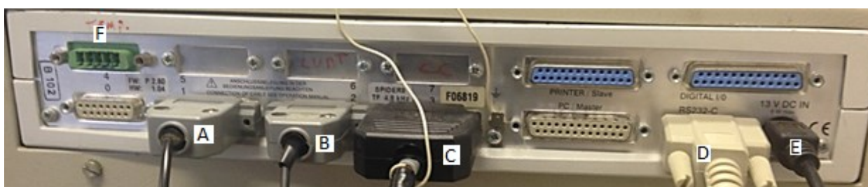
Figura 2.9 – Parte posterior do Spider8 com os cabos de comunicação com sensores e PC e cabo de alimentação.
