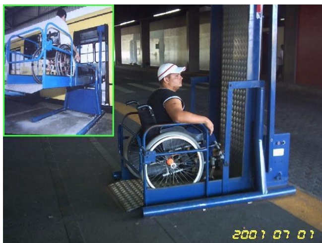
Figura 9 – Plataforma elevatória estacionária – Uberlândia, MG – 2007
