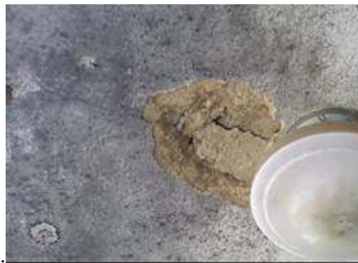
Figura 8.16– Deslocamento de reboco na marquise 06B
