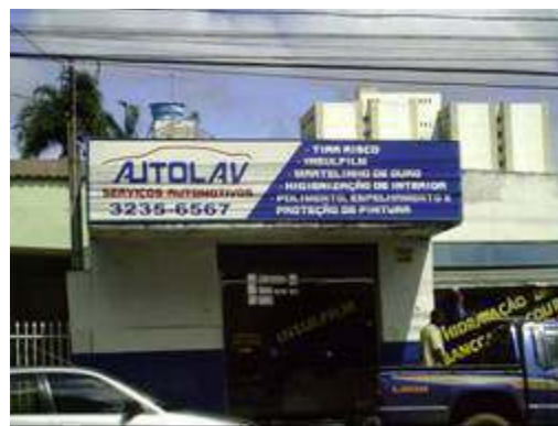
Figura 8.2 - Marquise com sobrecarga por painel Publicitário – Marquise 31U
