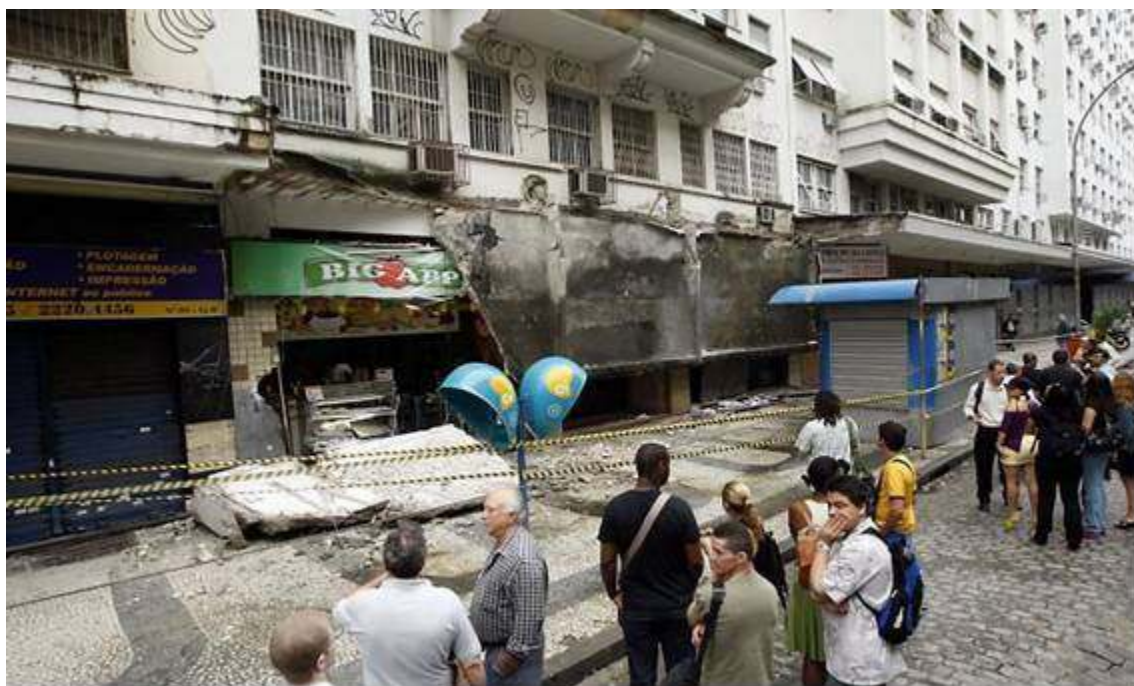
Figura 1.5 – Queda de Marquise no Rio de Janeiro (MASSET, 2006)
