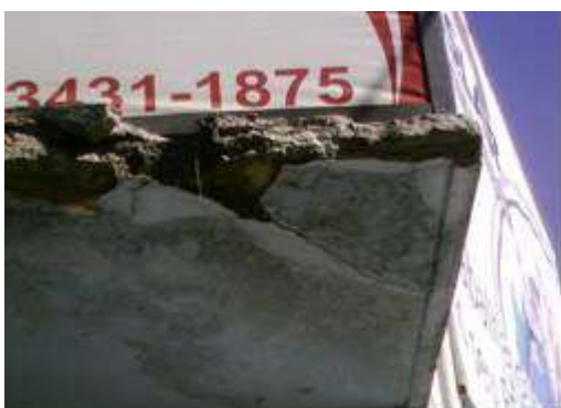
Figura 8.3 - Deslocamento de concreto, trinca e armadura exposta na marquise 06B.
