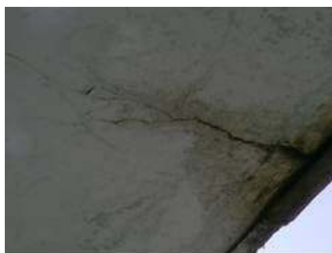
Figura 8.4 - Trinca com infiltração na marquise 06B.
