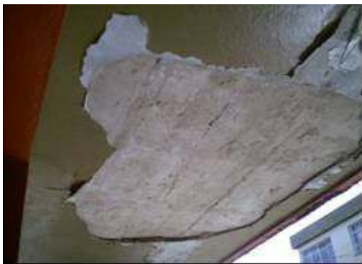
Figura 8.15– Deslocamento de reboco na Marquise 08B
