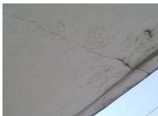
Figura 8.10 – Trinca na marquise 02B
