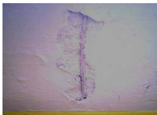
Figura 8.12– Armadura exposta na marquise 10B
