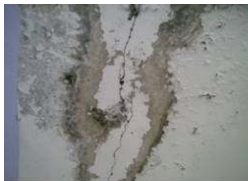
Figura 8.8 – Trinca na marquise 05B
