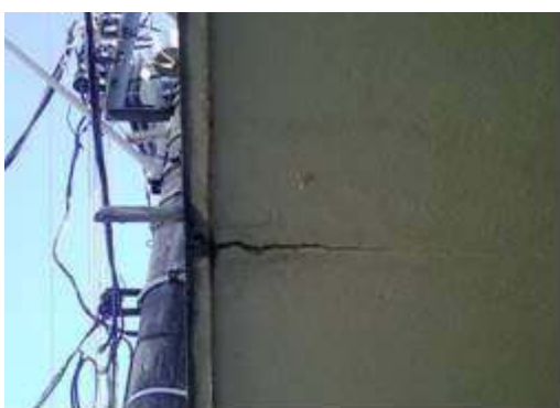
Figura 8.9 – Trinca na marquise 09B
