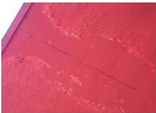
Figura 8.7- Trinca na marquise 10B
