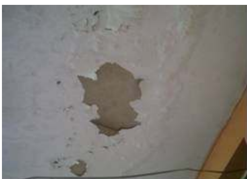
Figura 8.11 - Sinais de infiltração na marquise 10B.
