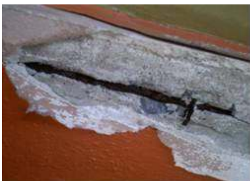
Figura 8.13 - Armadura exposta na marquise 08B.
