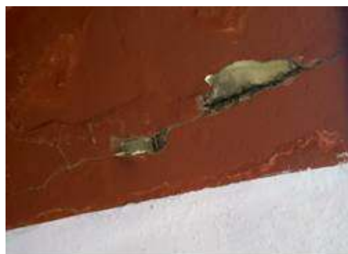
Figura 8.14 – Armadura exposta na marquise 10B.
