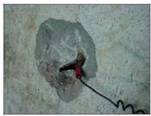
Figura 7.8 – Ligação do terminal positivo do voltímetro na Marquise
