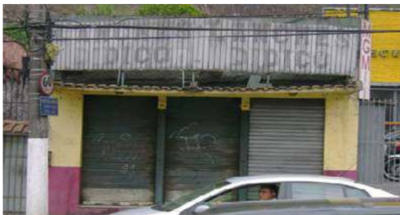
Figura 5.6 - Marquise deformada pela sobrecarga de painel publicitário. (RIZZO, 2007)
