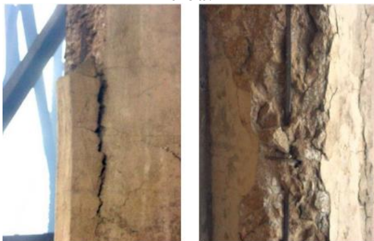
Figura 25: Lascamento de canto (sloughing) à esquerda; lascamento explosivo (explosive spalling) à direita.
