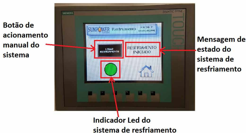
Figura 42 – Tela do sistema de resfriamento do painel fotovoltaico
