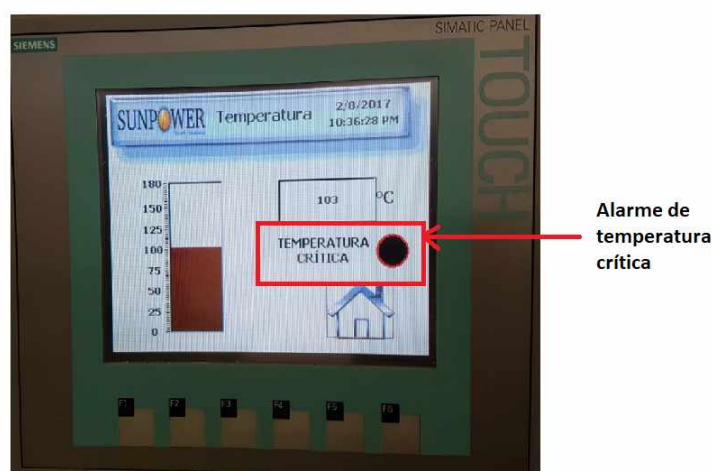
Figura 41 – Tela de monitoração da temperatura do painel fotovoltaico - Alarme de temperatura crítica
