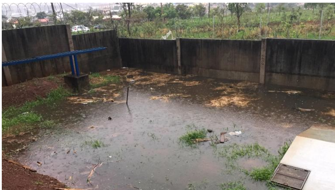
Figura 20 – Transbordamento da caixa de água pluvial
