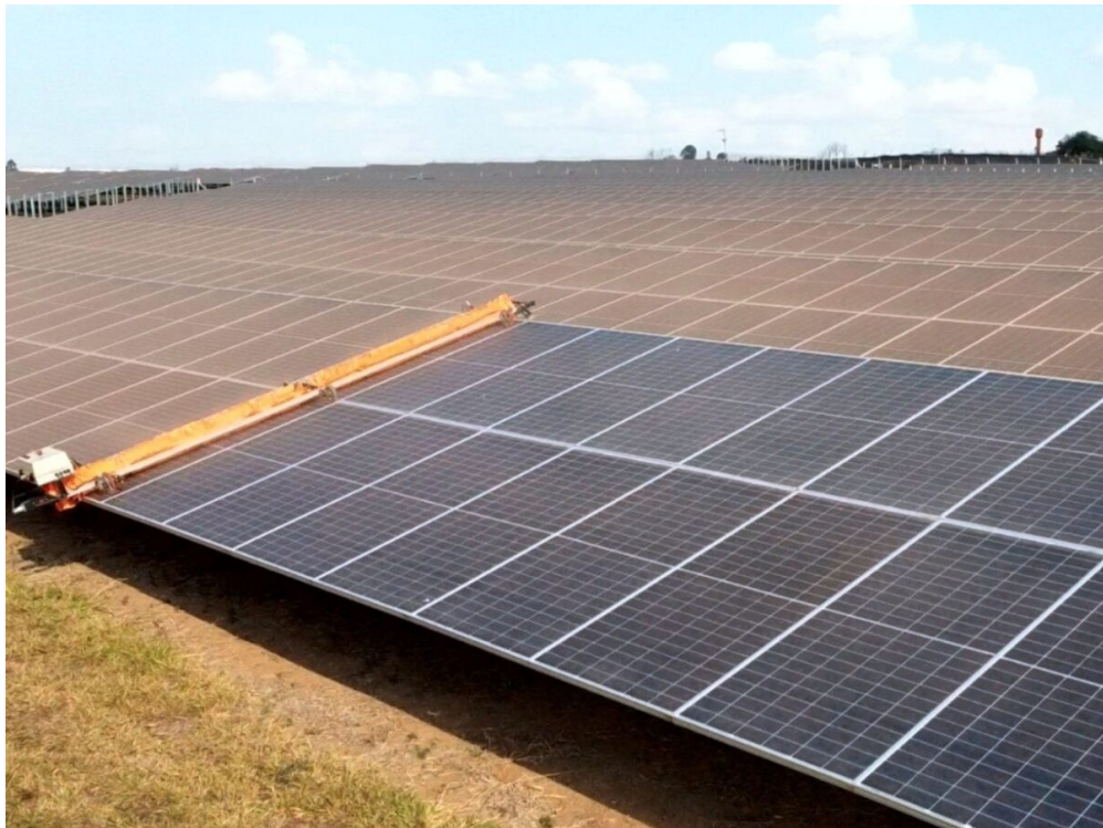
Figura 5 - Limpeza automatizada de módulos fotovoltaicos.
