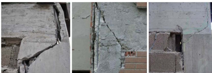
Figura 12 - Falha por cisalhamento de pilar devido a interação estrutura e alvenaria.
