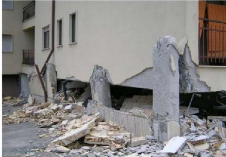
Figura 1 - Falha de colunas por cisalhamento devido as ações sísmicas
