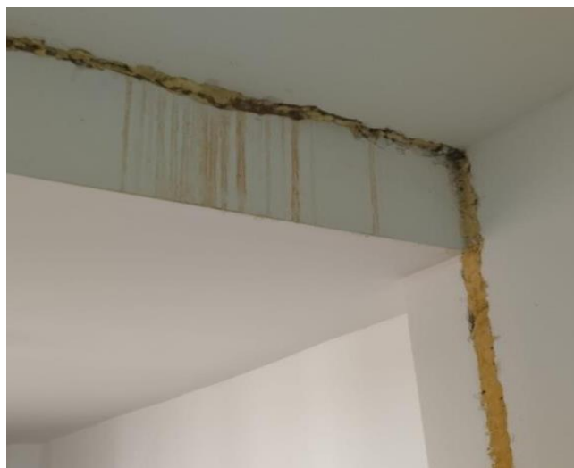
Figura 6 – Patologia em Junta de Dilatação (Infiltração)
