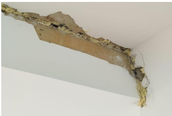
Figura 7 - Patologia em junta de Dilatação (Desplacamento Acabamento)
