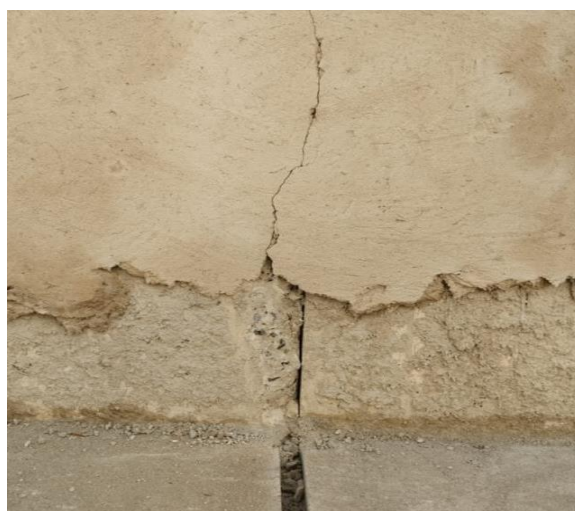
Figura 5 – Patologia em Junta de Dilatação (Fissura)
