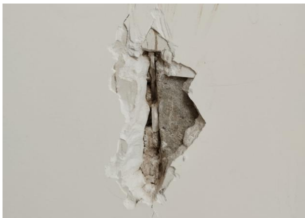
Figura 14 – Obstrução da Junta de Dilatação
