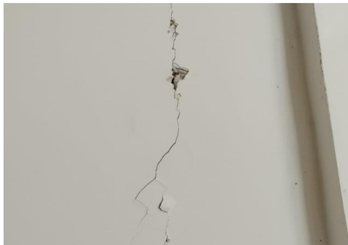
Figura 17 – Identificação da Patologia (Fissura)
