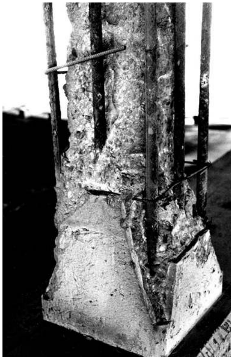
Figura 3.2 - Pilar com deterioração avançada (fonte: ACI Guide 546)
