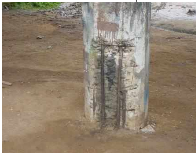
Figura 8 - Deterioração do concreto e corrosão das armaduras de um pilar
