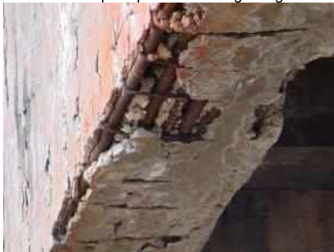
Figura 7 – Deterioração do concreto e corrosão das armaduras principais de uma viga longarina
