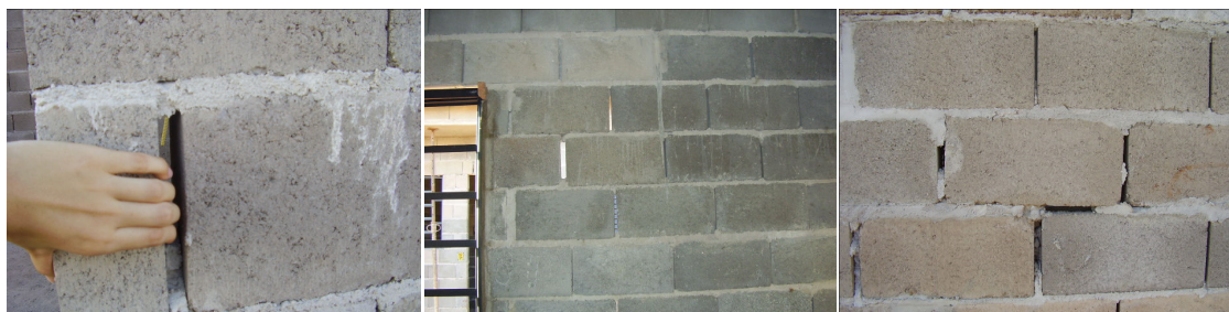
Figura 5.8 – Alvenaria empresa C – problemas de modulação
