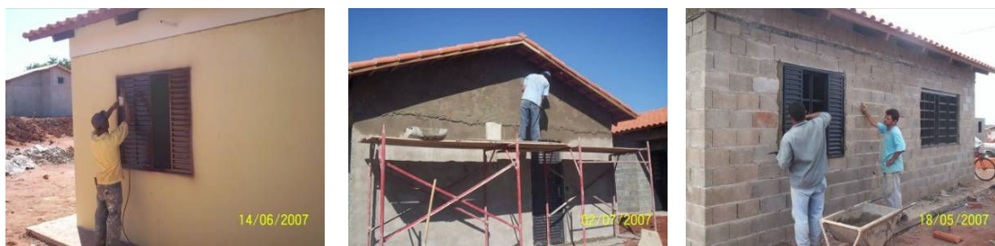
Figura 4.26 – Falta de uso de EPI
