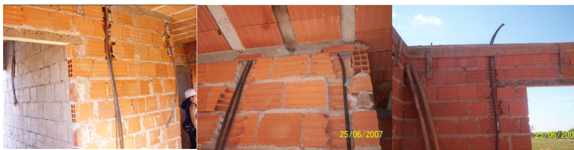
Figura 5.10 – Alvenaria empresa D – falta de um processo executivo racionalizado
