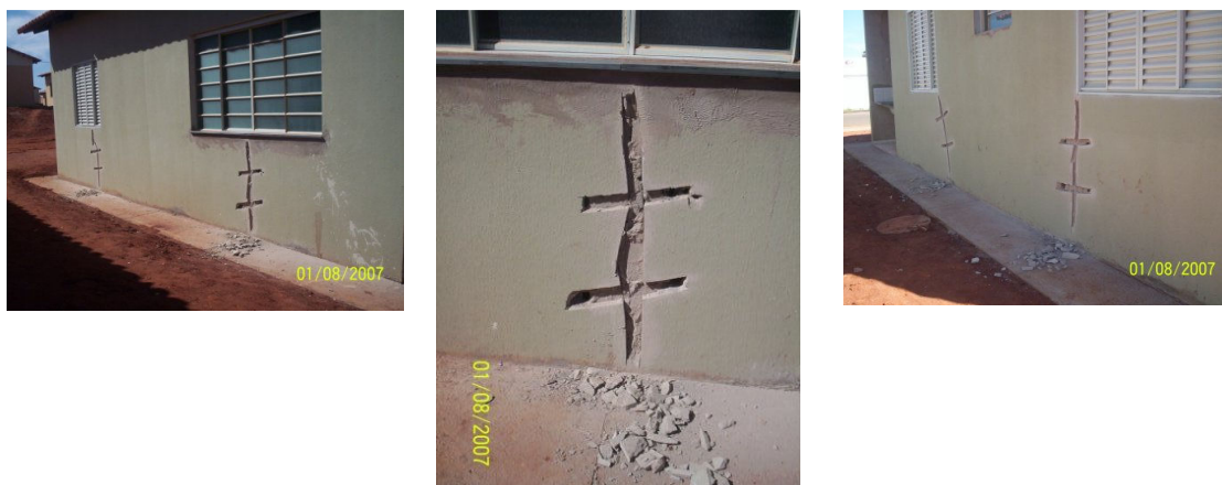
Figura 5.4 – Trincas externas nas casas da empresa B
