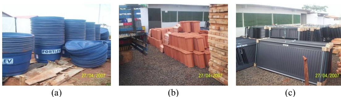
Figura 4.17 – Falta de identificação dos materiais estocados no canteiro – (a) caixas d’água armazenadas sem identificação; (b) telhas armazenadas sem identificação e longe do local de produção; (c) esquadrias estocadas fora dos padrões recomendados pelo PMA
