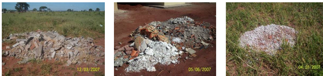
Figura 4.24 – Entulho e perdas de materiais
