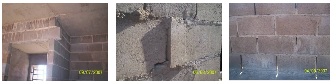
Figura 5.7 – Alvenaria empresa A – problemas de modulação
