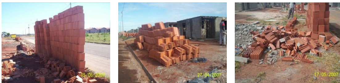
Figura 4.21 – Estocagem incorreta de tijolos e telhas
