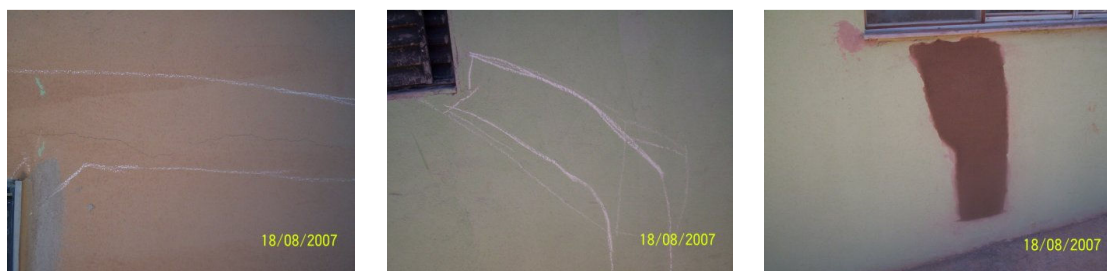
Figura 5.5 – Trincas externas nas casas da empresa C
