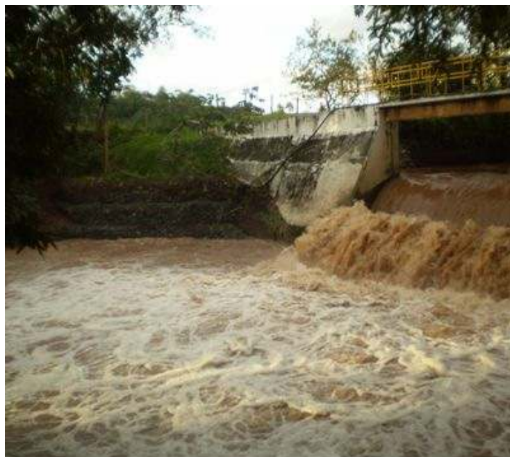
Figura 23. Vertedouro da barragem de captação da COPASA no dia 21 de abril de 2008, após 03 dias de precipitações com total acumulado médio de mais de 80mm. Observe o volume de água (aproximadamente 120% maior do que o volume médio) e a quantidade de sedimentos carregados pela água.
