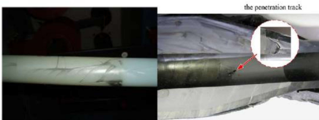
Figura 2 – Carbonização interna no cabo e caminho de penetração na junção do cabo
