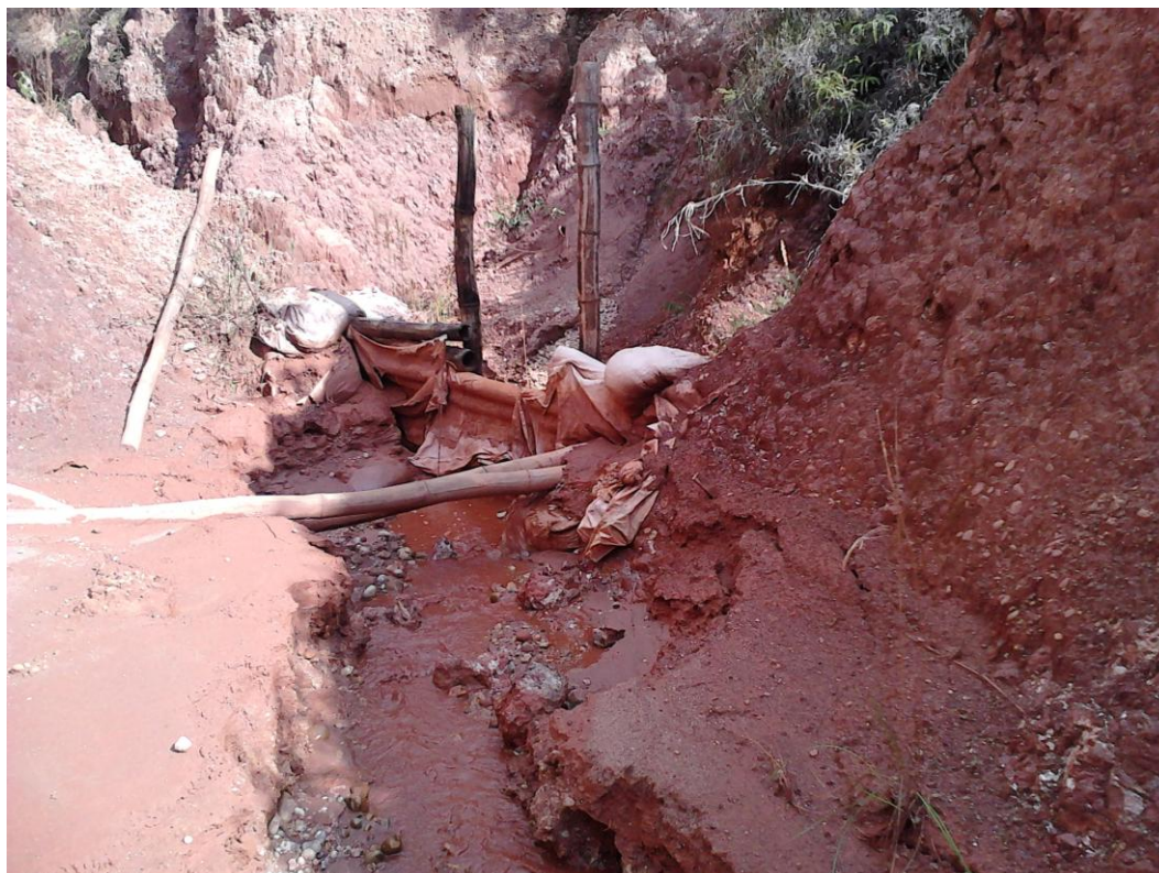
Figura 36 - B2B rompida mostrando sedimento ainda retido na barreira. Autor: PEREIRA, 2012.
