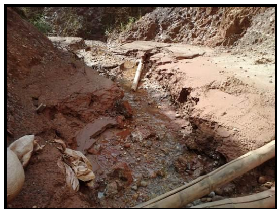
Figura 32 – Situação a montante da barreira B2B após esvaziamento da água do represamento, mostrando sedimentos acumulados. Autor: PEREIRA, 2012.
