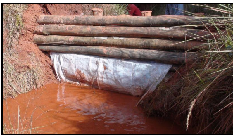
Figura 17 - Barreira de madeira construída sem os devidos cuidados com o encaixe da paliçada na parede da voçoroca. Autor: PEREIRA, 2011.
