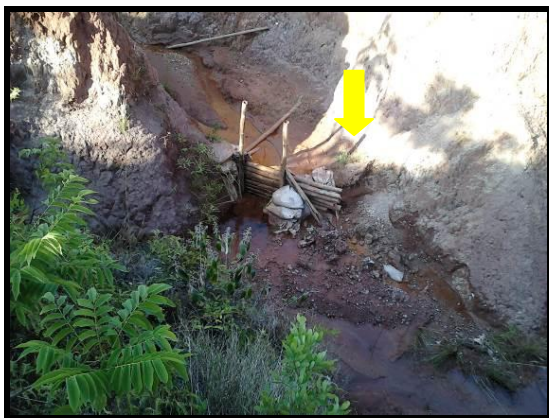
Figura 33 - B2B Rompida na lateral. Autor: PEREIRA, 2012.
