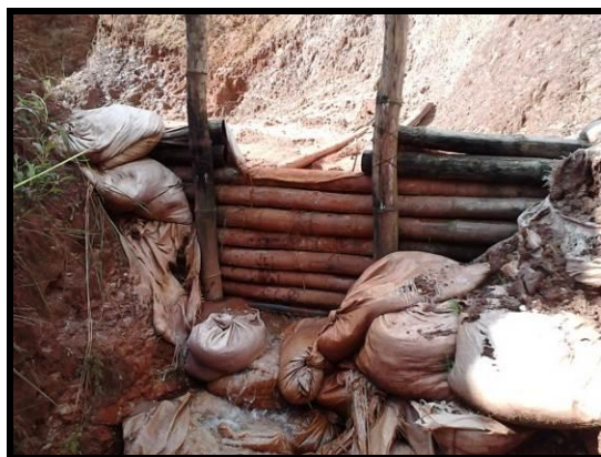
Figura 31 – Situação do sitio da B2B após rompimento. Autor: PEREIRA, 2012.
