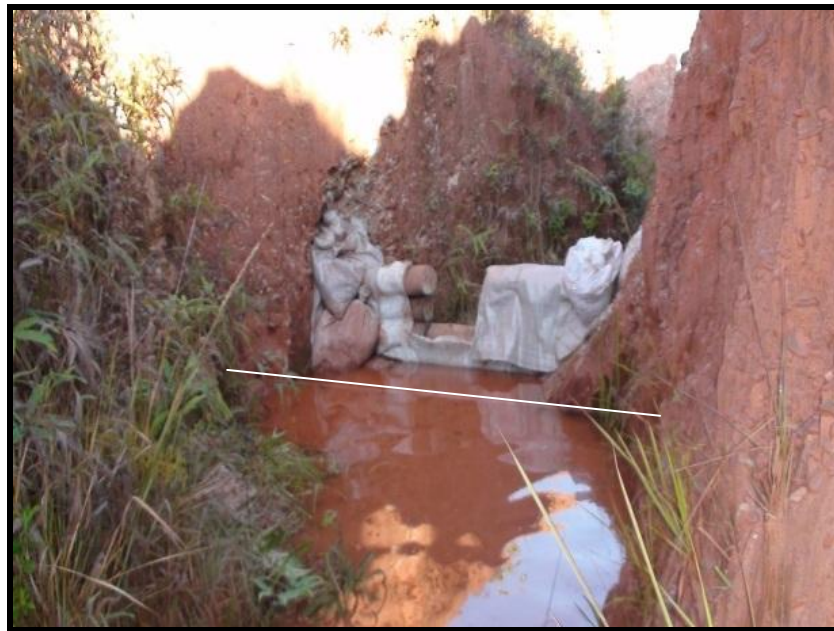
Figura 15 - Fio de náilon para monitoramento de sedimento retido antes da barreira. Autor: PEREIRA, 2011.
