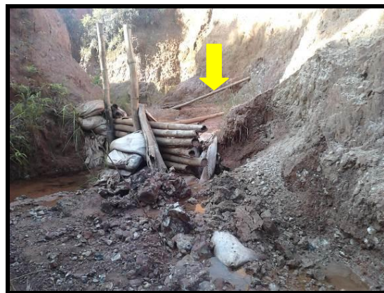
Figura 34 - B2B Rompida na lateral. Autor: PEREIRA, 2012.
