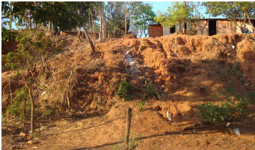
Figura 33 - Ocupação de terreno próximo a talude na Vila Atlântica Autor: Leite, 2010.
