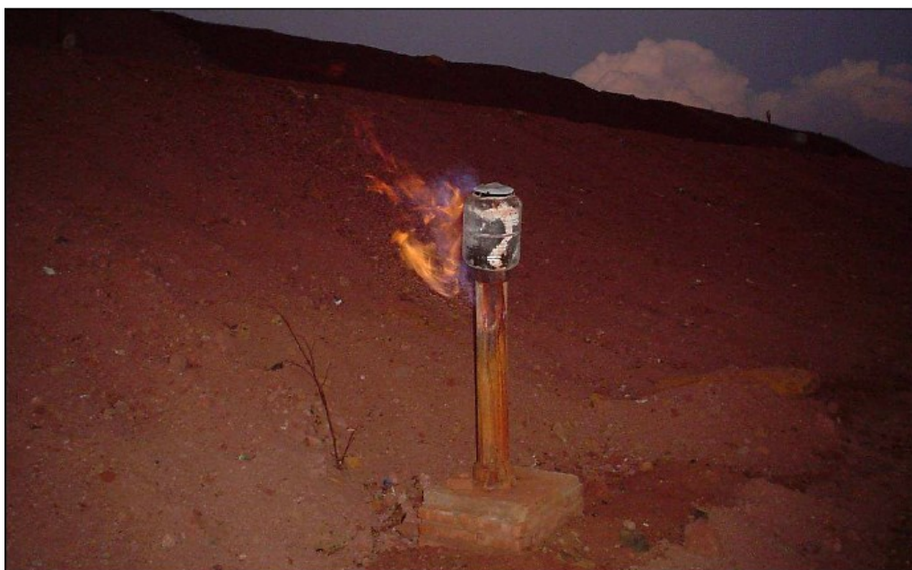
Figura 6 – Queimador tipo flare instalado no topo de um Dreno de Gases e Percolados – DGP em momento no qual está sendo promovida a queima do biogás gerado pela biodegradação dos resíduos aterrados. Fonte: LIMPEBRÁS, 2012.
