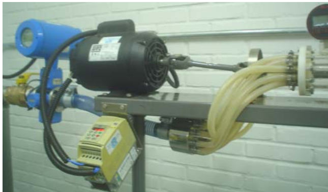
Figura 5.2: Válvulas para ajuste da vazão, medidor magnético, motor e o distribuidor de fluxo.
