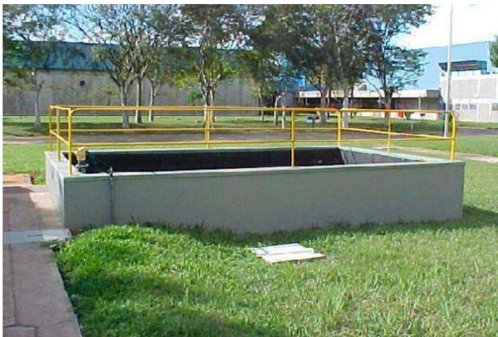
Figura 76 - Tanque de armazenagem - Etapa do tratamento secundário da água utilizada pela Souza Cruz. Foto: (SOUZA, 2005, p. 53).
