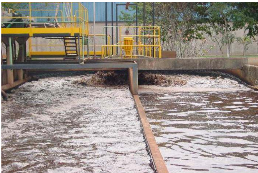
Figura 74 - Valo de oxidação - Etapa do tratamento secundário da água utilizada pela Souza Cruz. Foto: (SOUZA, 2005, p. 50).
