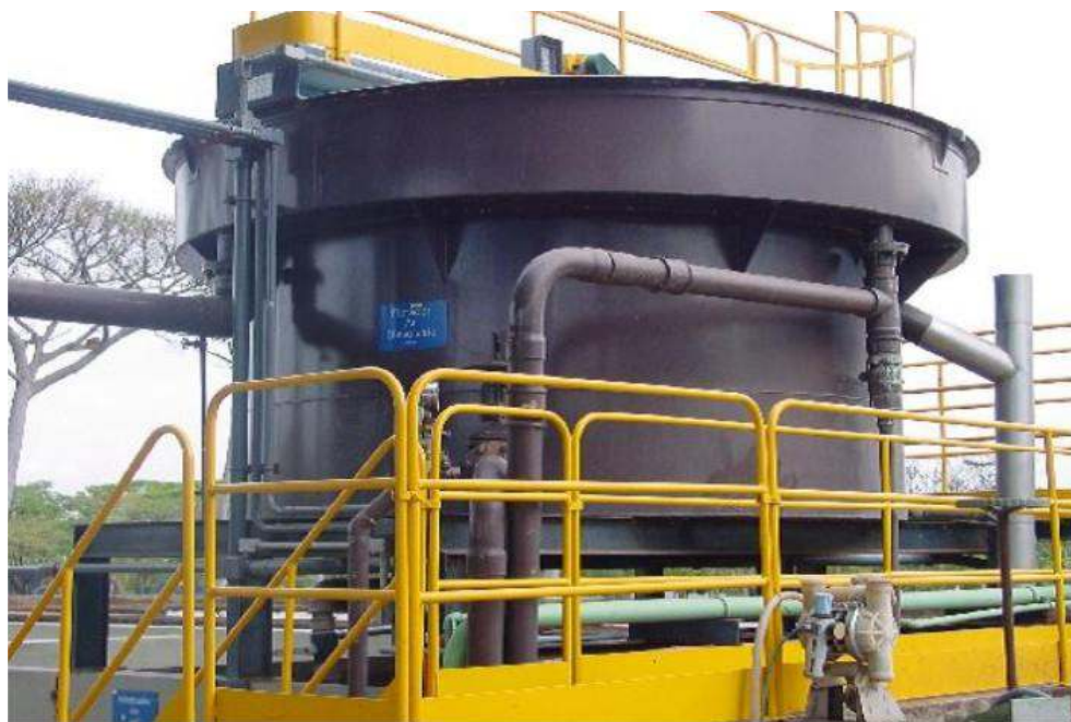
Figura 78 - Flotador de ar dissolvido - Etapa do Tratamento Terciário da água utilizada pela Souza Cruz. Foto: (SOUZA, 2005, p. 55).
