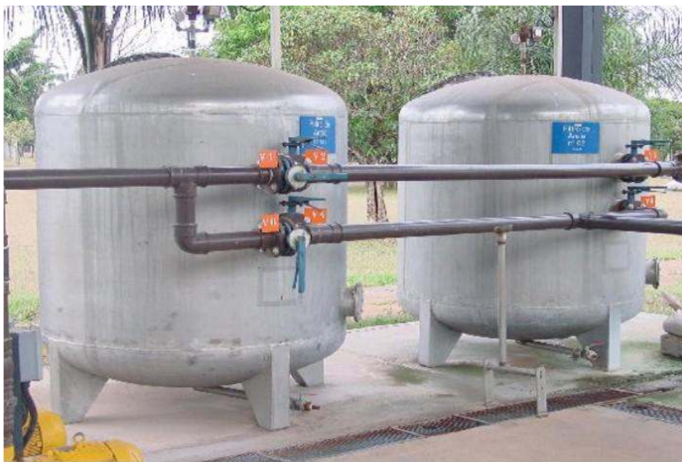
Figura 80 - Filtros de areia - Etapa do Tratamento Terciário da água utilizada pela Souza Cruz. Foto: (SOUZA, 2005, p. 57).
