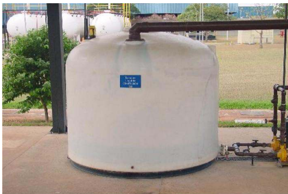
Figura 79 - Tanque de líquido clarificado - Etapa do Tratamento Terciário da água utilizada pela Souza Cruz. Foto: (SOUZA, 2005, p. 56).
