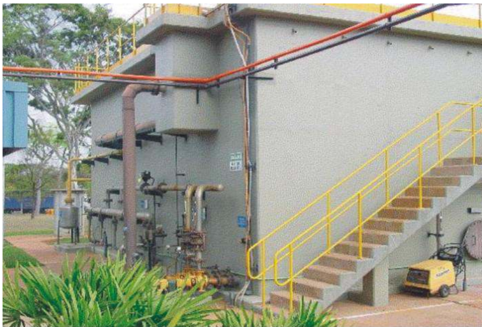
Figura 72 - Reator metanogênico - Etapa do tratamento secundário da água utilizada pela Souza Cruz. Foto: (SOUZA, 2005, p. 49).
