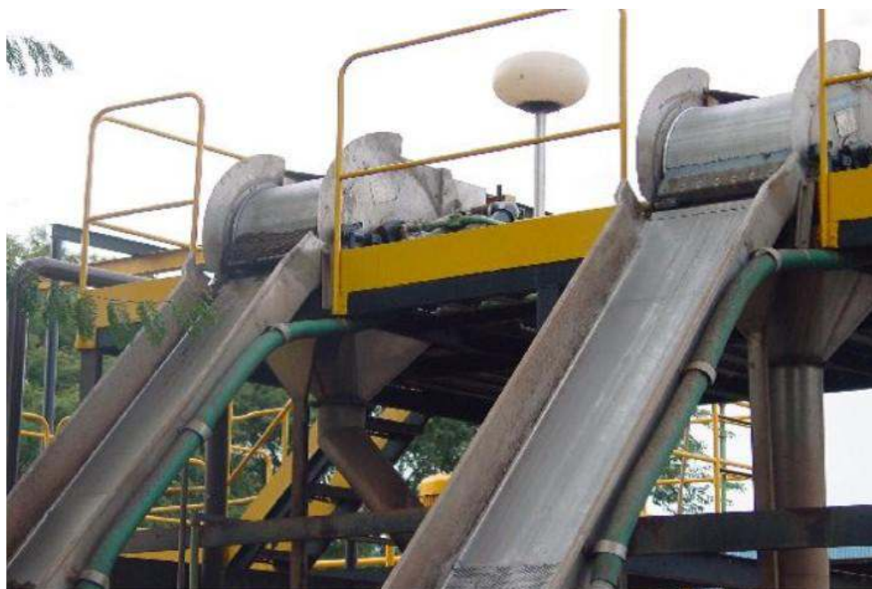
Figura 69 - Peneiras rotativas - Etapa do tratamento primário da água utilizada pela Souza Cruz. Foto: (SOUZA, 2005, p. 46).
