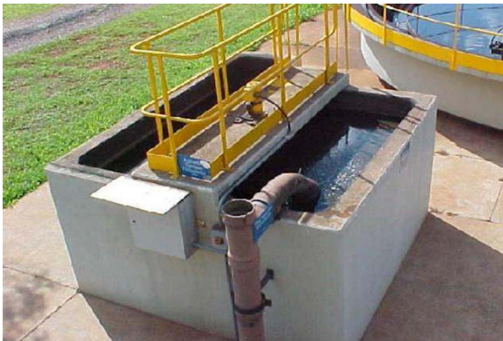
Figura 70 - Tanque de floculação - Etapa do tratamento primário da água utilizada pela Souza Cruz. Foto: (SOUZA, 2005, p. 48).
