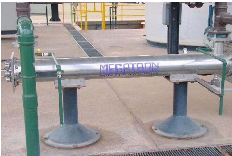
Figura 81 - Equipamento de ultravioleta - Etapa do Tratamento Terciário da água. Foto: (SOUZA, 2005)
