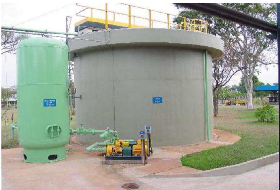
Figura 82 - Reservatório de água para o reúso. Foto: (SOUZA, 2005, p. 57).
