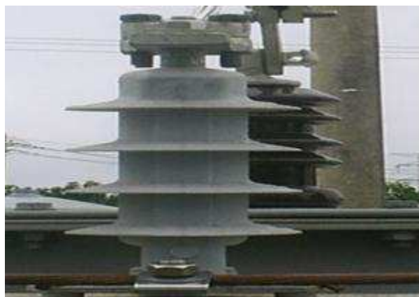
Figura 4.2 – Para Raios para proteção do Reator.
