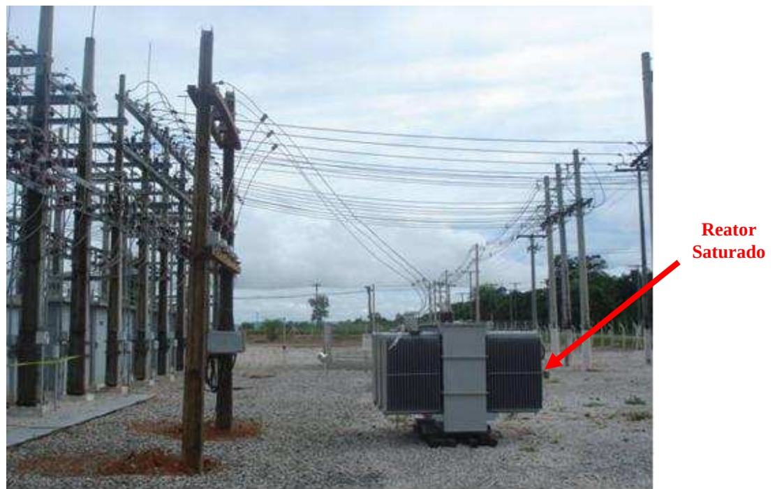
Figura 4.9 – Vista 2 do reator instalado na subestação Coxipó.
