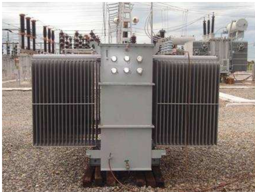
Figura 3.9 – Reator twin-tripler na subestação de testes – vista 3.
