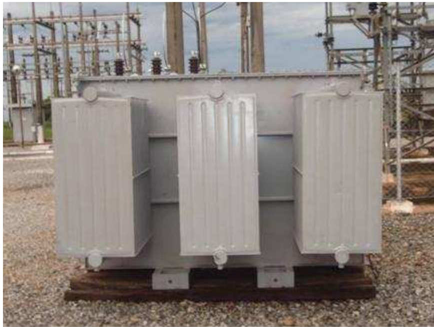
Figura 3.8 – Reator twin-tripler na subestação de testes – vista 2.
