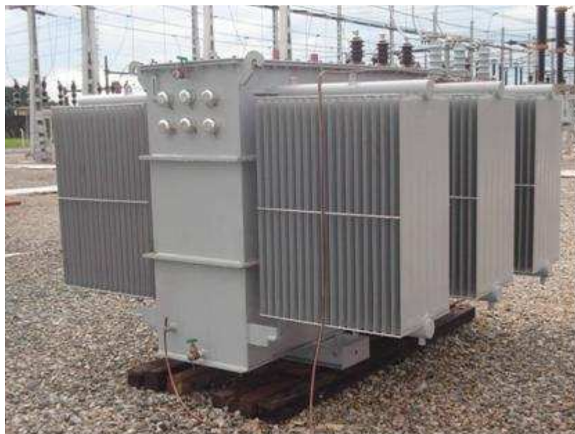
Figura 3.7 – Reator twin-tripler na subestação de testes – vista 1.
