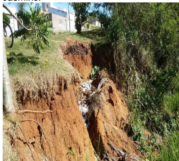
Figura 8: Erosão na APP na rua Dos Jasmins.
