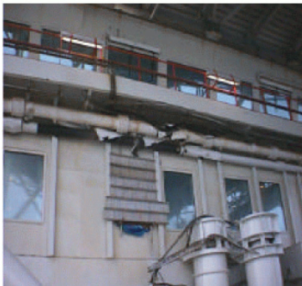
Figura 3.2 – Danos causados na proa do FPSO Varg. Fonte: Kleefsman (2005)
