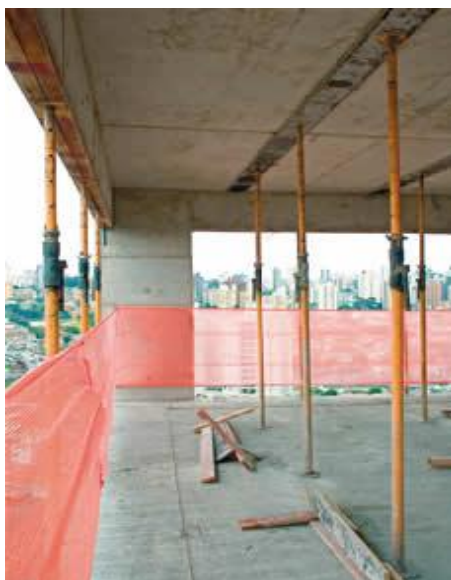
Figura 2 – Escoras metálicas. Fonte: Técnica (2007)
