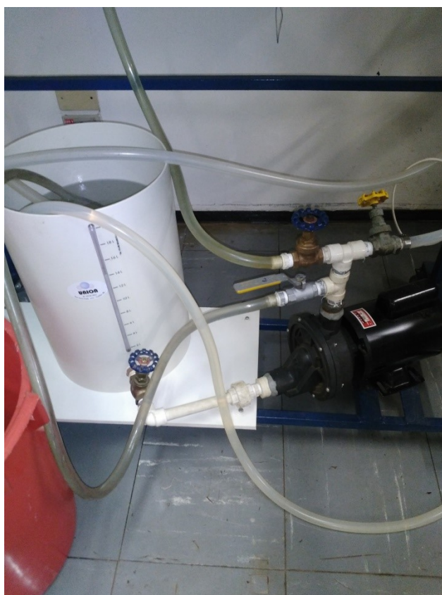
Figura 3.6 By-pass instalado com retorno para o reservatório de água
