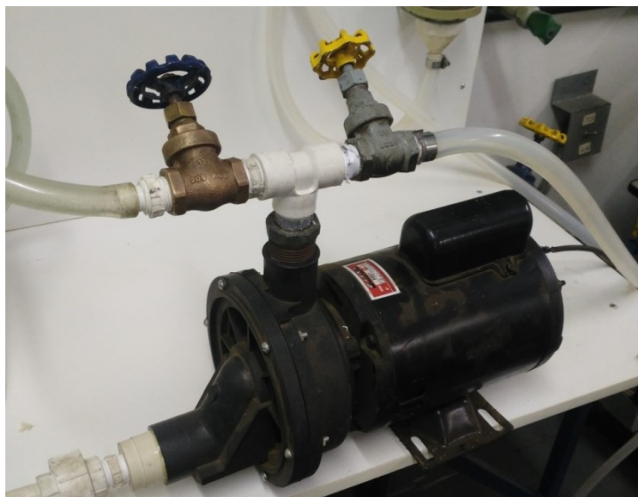
Figura 3.4 Bomba instalada e válvulas para operação independente dos leitos
