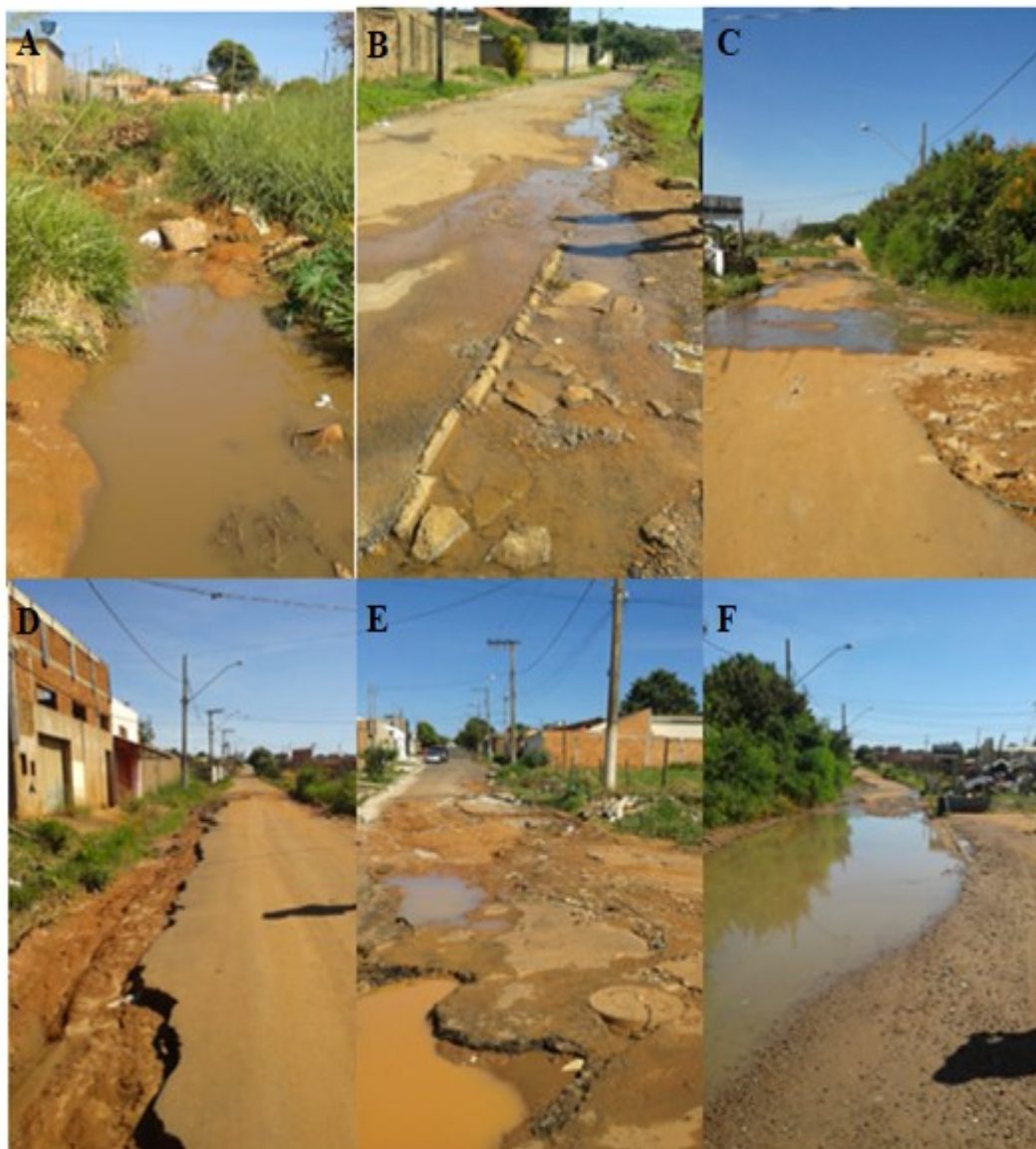
Mosaico 6- Ausência de drenagem pluvial no Bairro São Jorge
