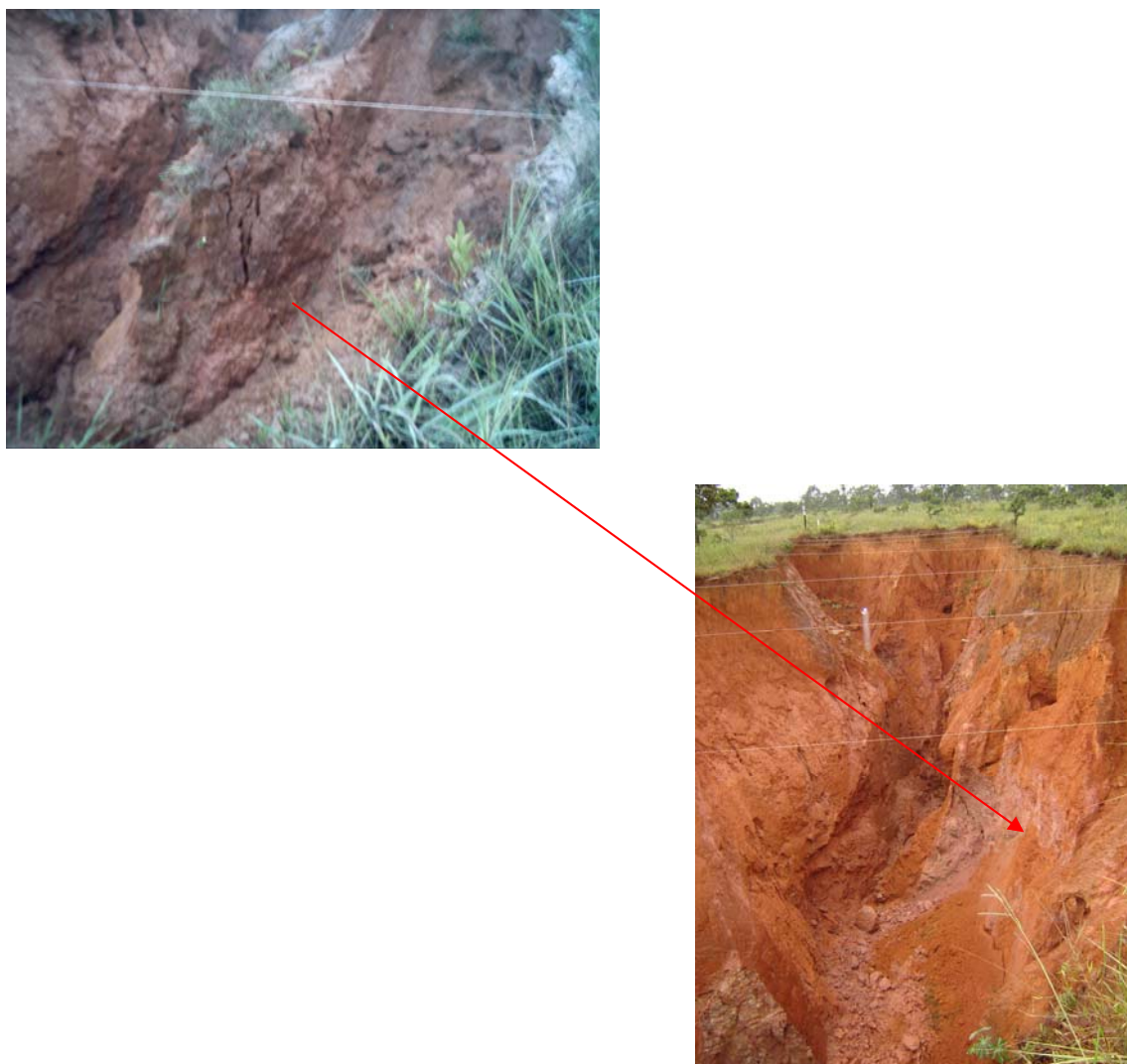
Fig. 29 – (A) Rachaduras na parede da voçoroca local onde ocorreu a queda do talude. (B) Queda do talude. Autor: ROCHA, E. A. V./ 2005.
