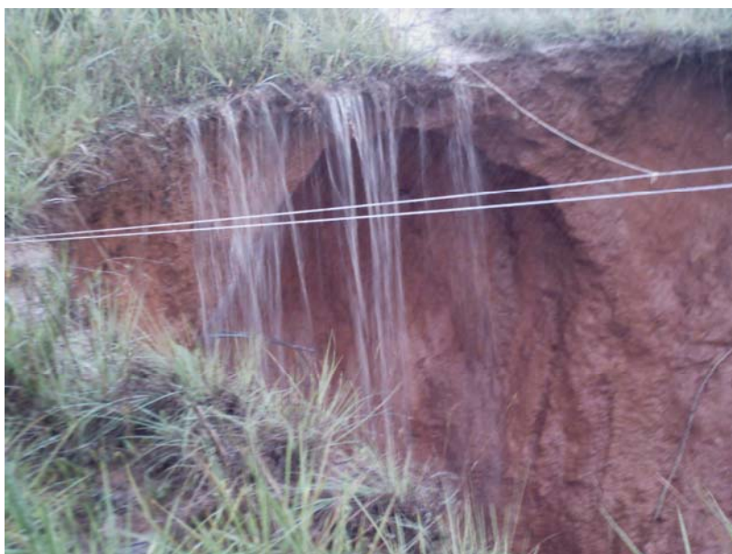
Fig. 26– Processo de encachoeiramento do fluxo superficial na borda da voçoroca.
