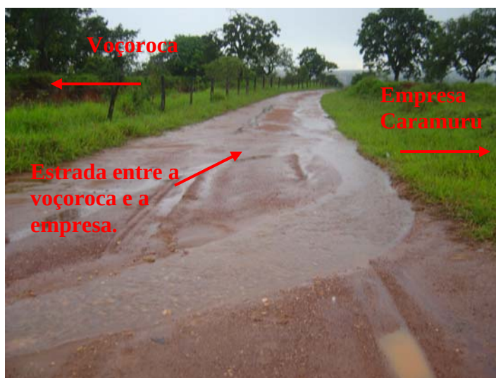
Fig. 25 – Fluxo de escoamento pluvial concentrado na estrada. Autor: ROCHA, E. A. V. dez../2005.
