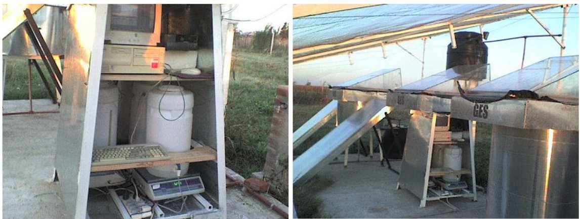
Figura 2.15 – Sistema de medições e instalações completa com conjunto de dessalinizadores
