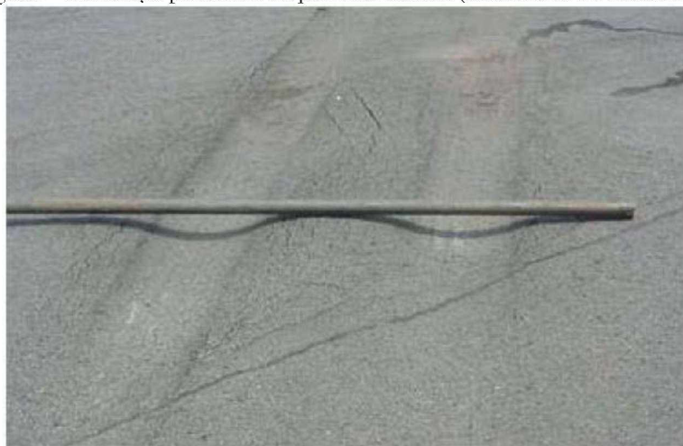
Figura 3 – Deformação permanente em pavimento asfáltico (afundamento em trilha de roda).
