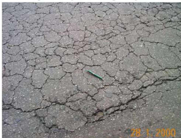
Figura 4 - Trincamento tipo couro de jacaré causada por fadiga de revestimentos asfálticos
