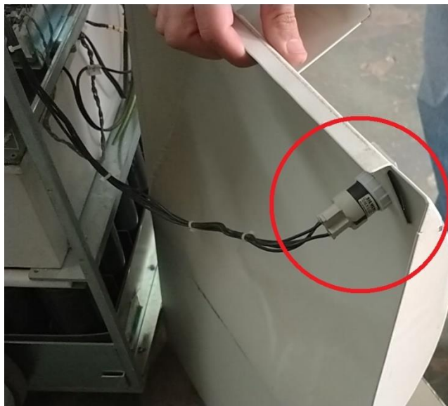
Figura 29: fiação da alimentação atravessando a superfície frontal
