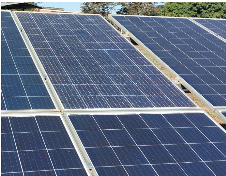
Figura 5 - Módulo com Vidro temperado trincado
