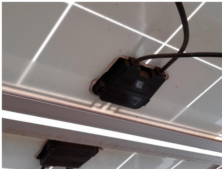
Figura 9 – Caixa de junção de um módulo fotovoltaico
