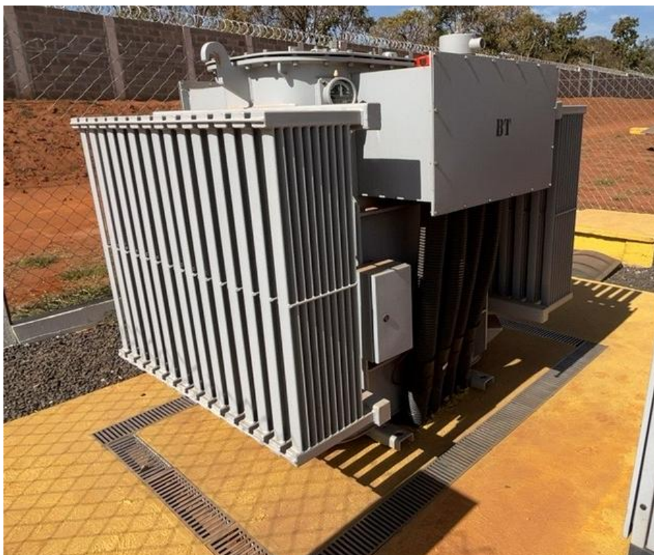
Figura 11 - Transformador em uma usina de Mini-geração
