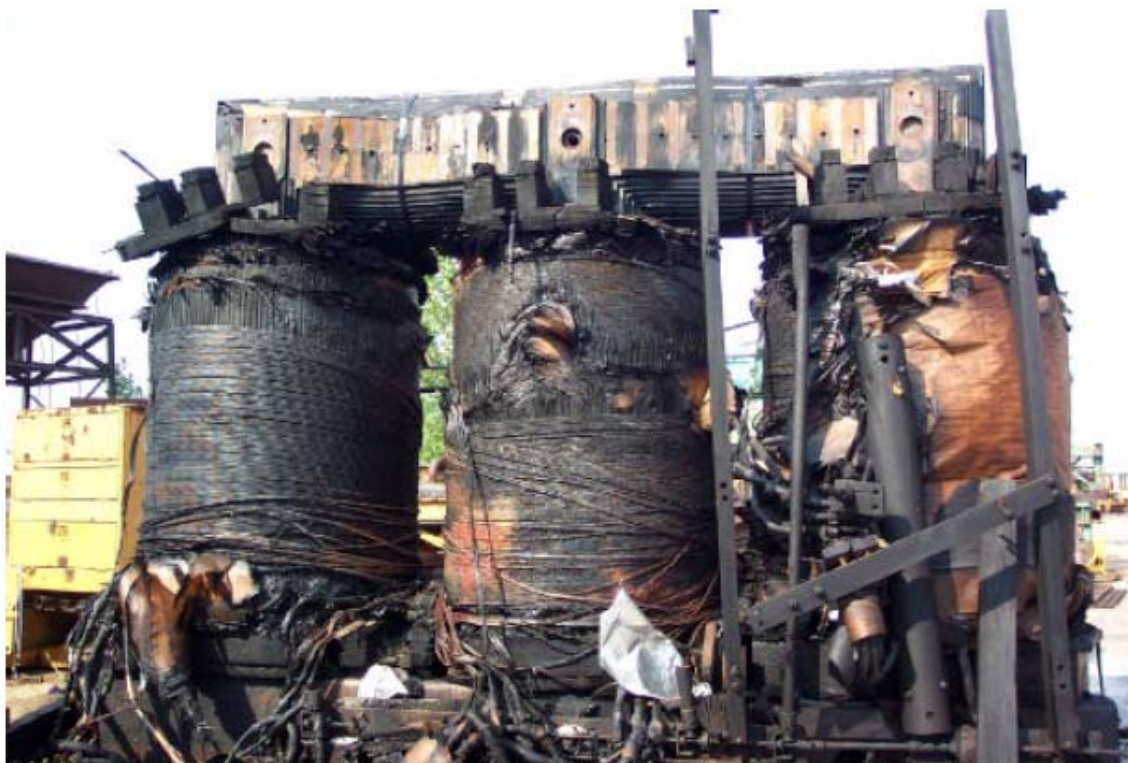
Figura 2.1 - Transformador danificado após ocorrência de uma falha.
