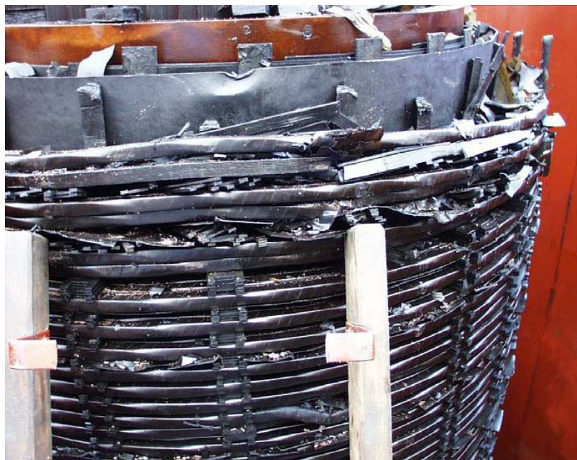
Figura 2.31 - Colapso axial devido a uma excessiva força axial causada por um curto-circuito.
