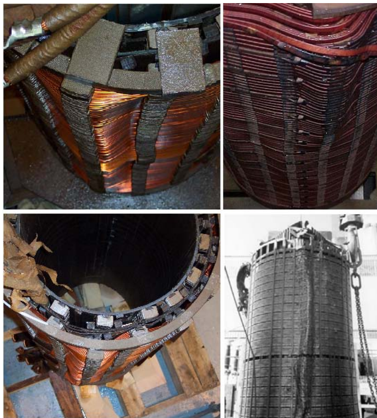
Figura 2.29 - Falha em enrolamentos devido à uma alta compressão radial causando uma saliência nos mesmos – free buckling.
