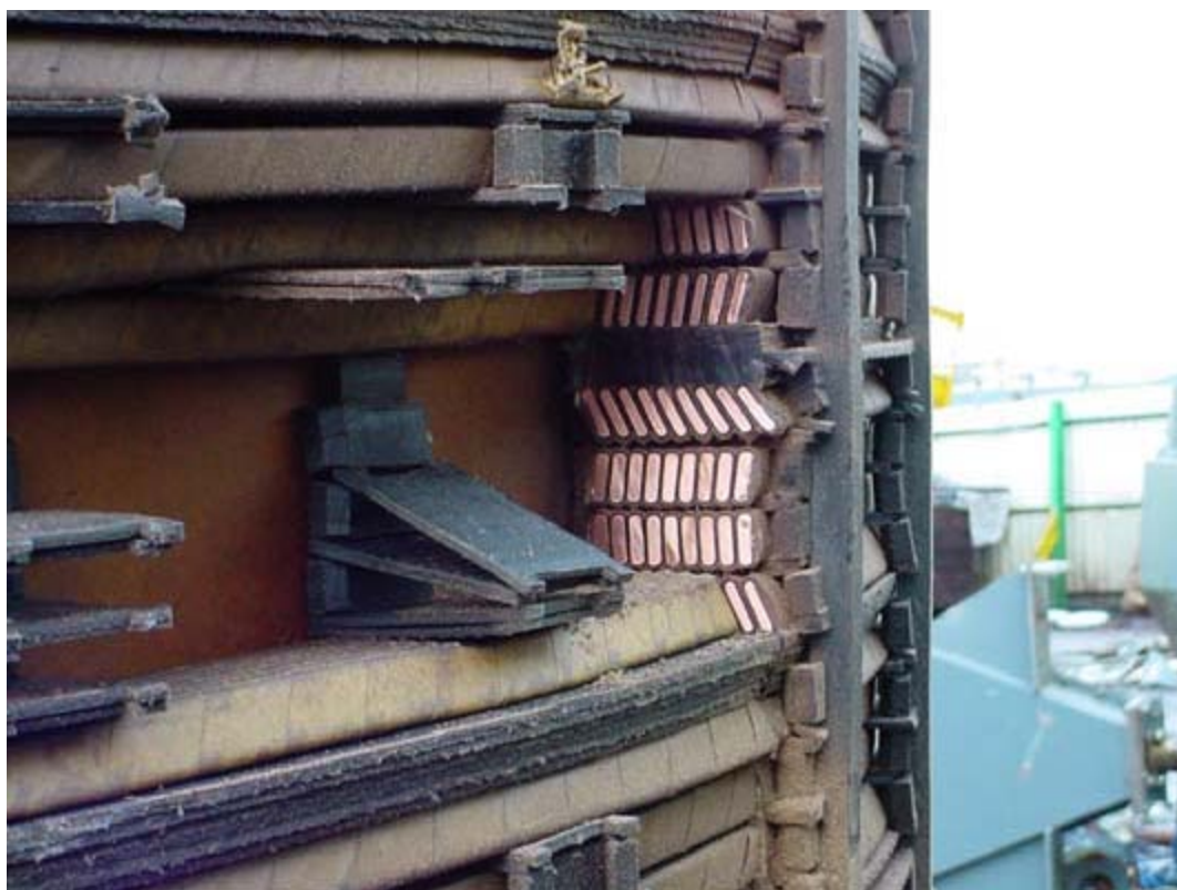
Figura 2.35 - Ocorrência do fenômeno de tombamento (Tilting) – Os condutores deveriam estar todos na vertical.
