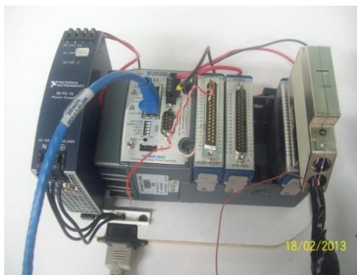
Figura 7.18. Controlador industrial utilizado.
