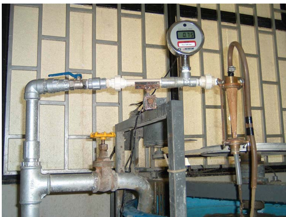
Figura 3.10 – Sistema de bypass , manômetro digital e um hidrociclone filtrante em funcionamento
