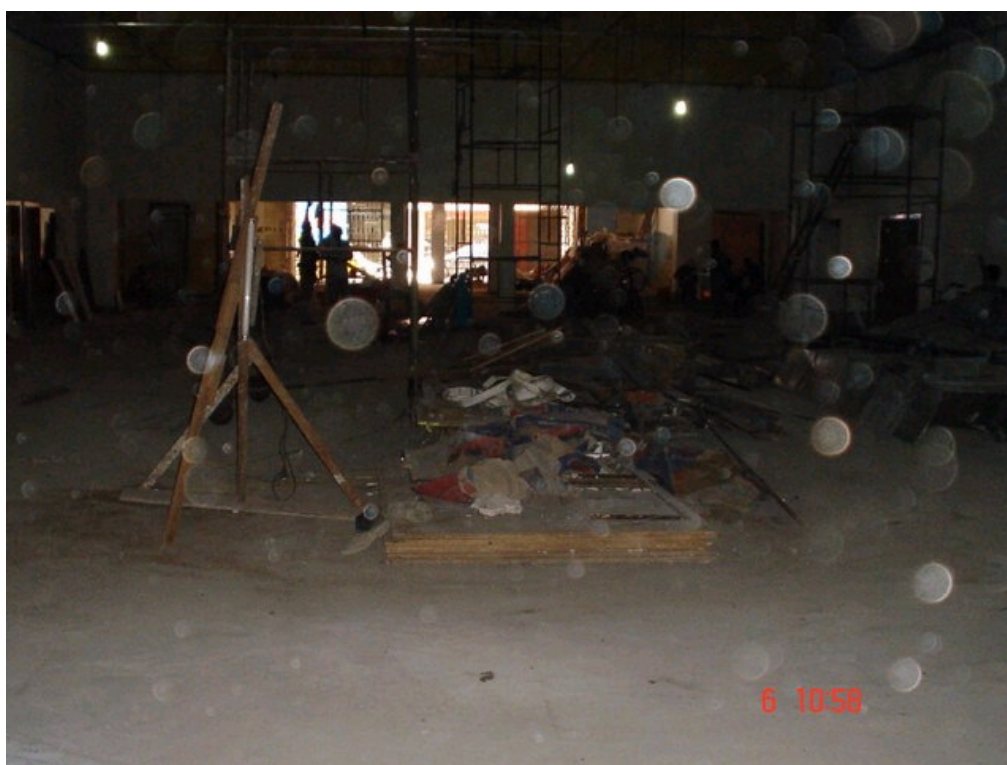
FIGURA 21: Escombros do Cine Bristol em 2007. Fonte: CASTRO, Kellen C.;
