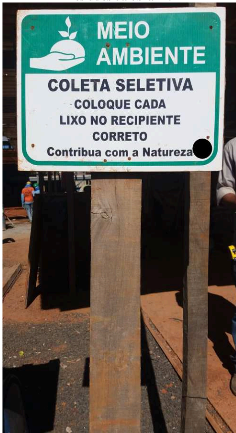
Figura 6 - Placa indicativa de organização dos resíduos da obra M.
