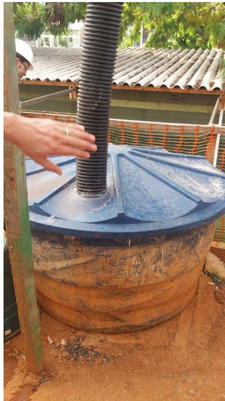
Figura 12 - Mecanismo de aproveitamento de águas pluviais da obra M.
