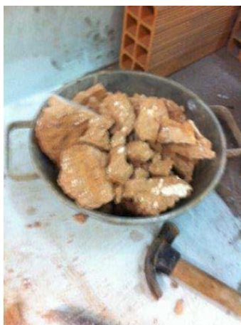
Figura 23 – Argamassa separada do tijolo cerâmico.
