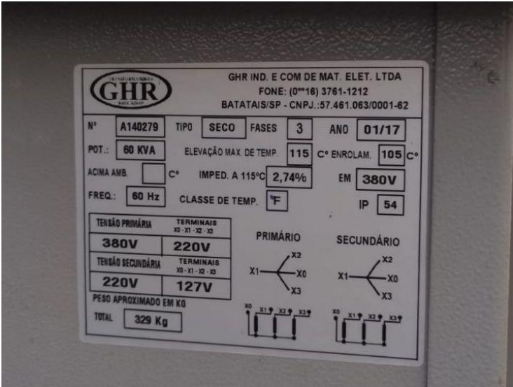
Figura 7 – Especificações técnicas do transformador que energiza o eletroposto
