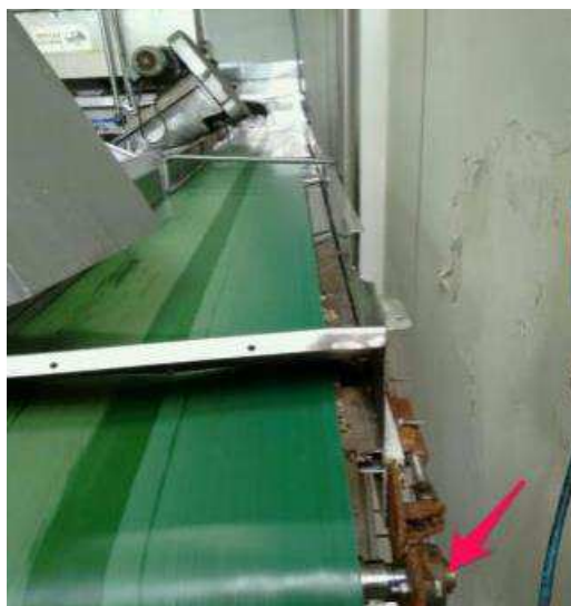
Fotografia 11. Esteira de saída de resíduo.
