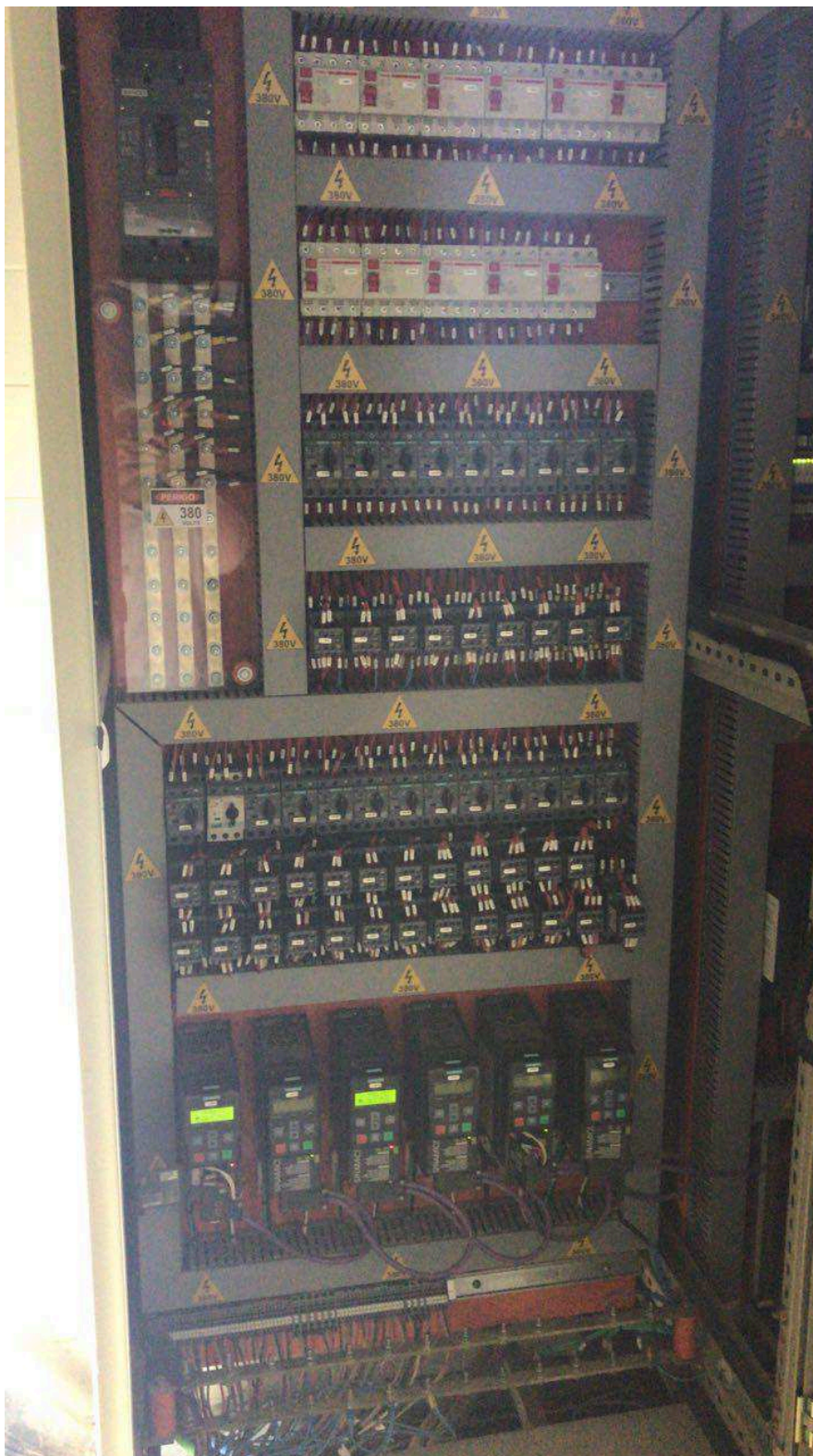
Fotografia 17. Painel elétrico de potência.
