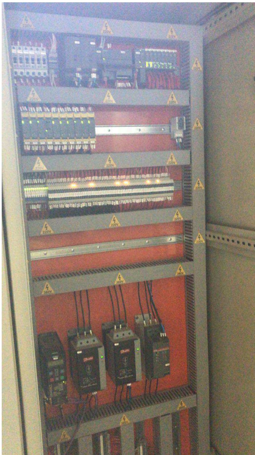
Fotografia 18. Painel elétrico de controle e acionamentos.
