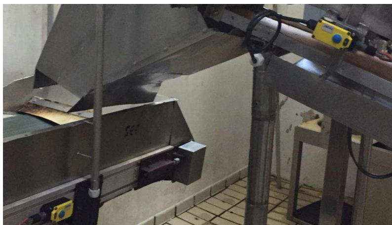
Fotografia 30. Esteira de saída de resíduo.
