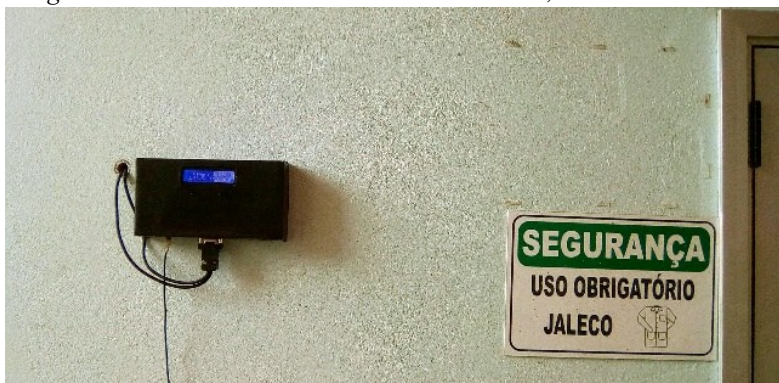
Figura 5.5 – Central instalada na câmara úmida, ao lado da entrada.
