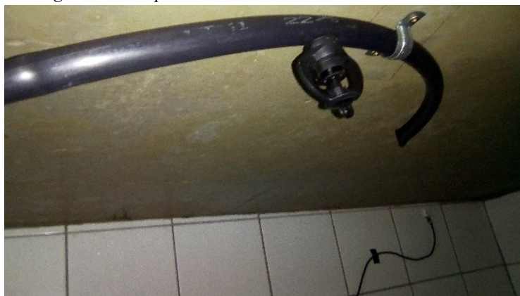
Figura 5.8 – Aspersor e sensor instalados na câmara úmida.
