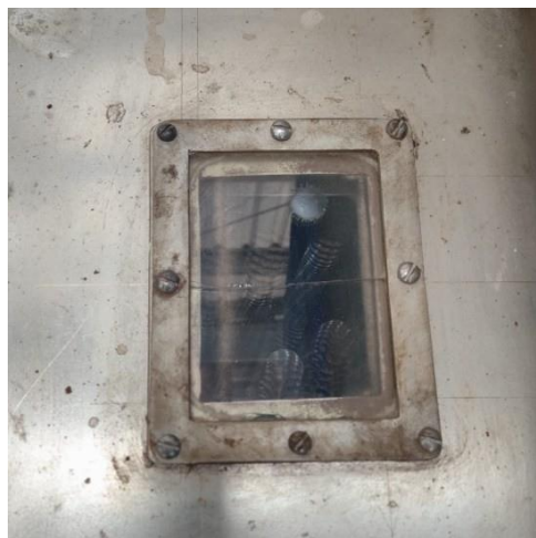
Figura 2: foto das resistências elétricas utilizadas no sistema de aquecimento do secador.
