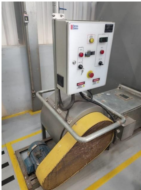
Figura 3: ventiladores, sistema de controle e caixa de resistências elétricas do secador
