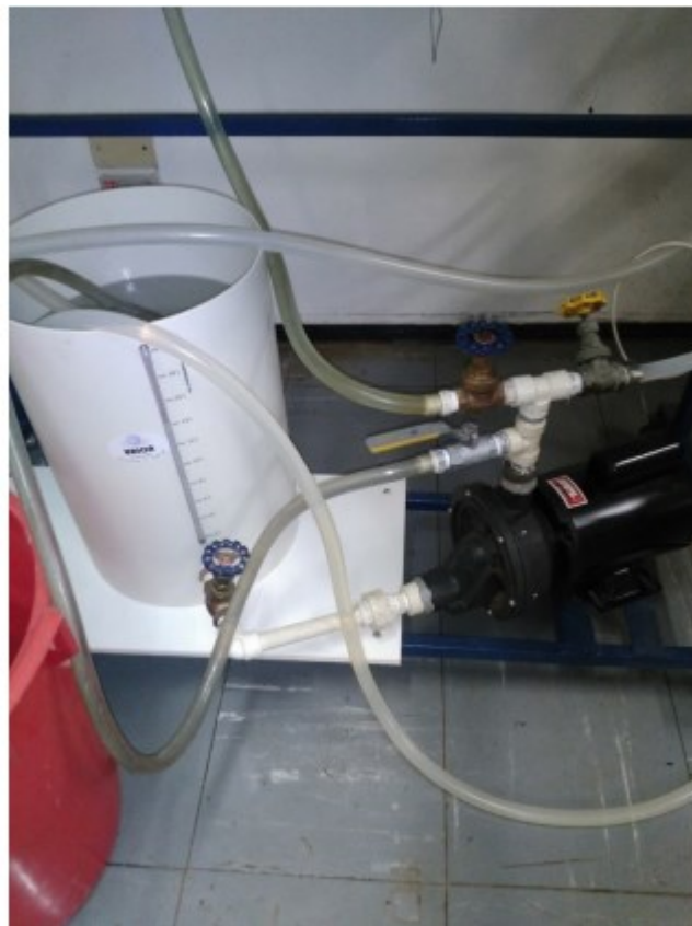
Figura 3.2 – Reservatório de água e bomba da unidade experimental original. Fonte: BORGES, 2017.
