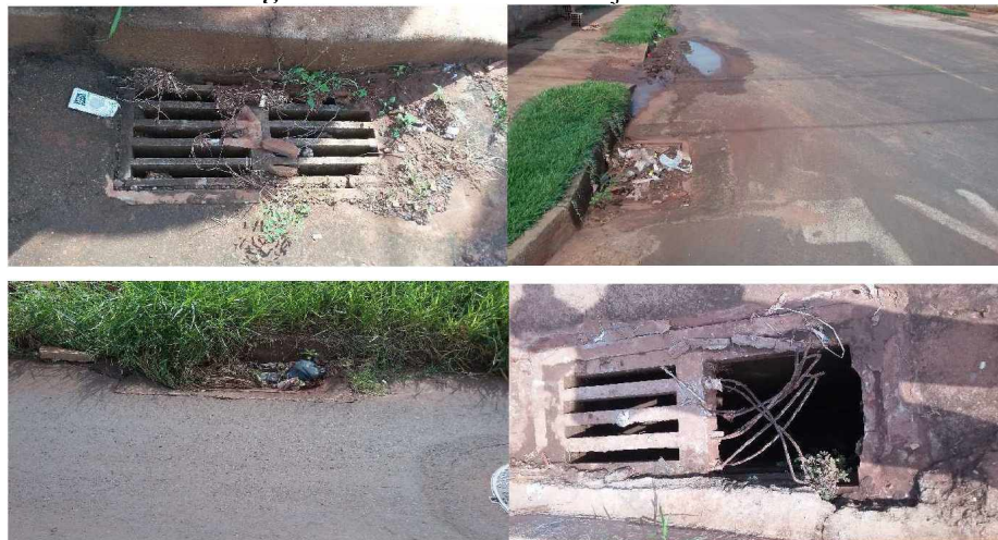
Figura 20: Bocas de Lobo sujas ou danificadas
