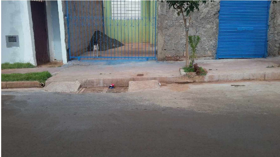
Figura 21: Boca de lobo obstruída
